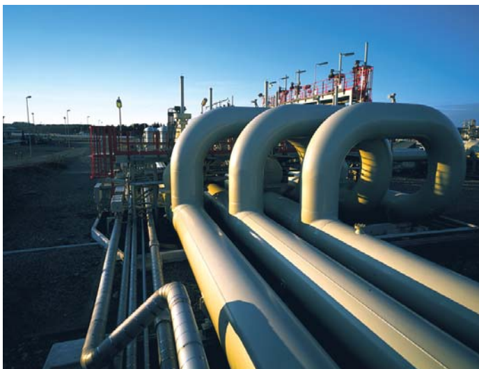
Hệ thống đường ống dẫn khí của Sonatrach. Nguồn: ABB
